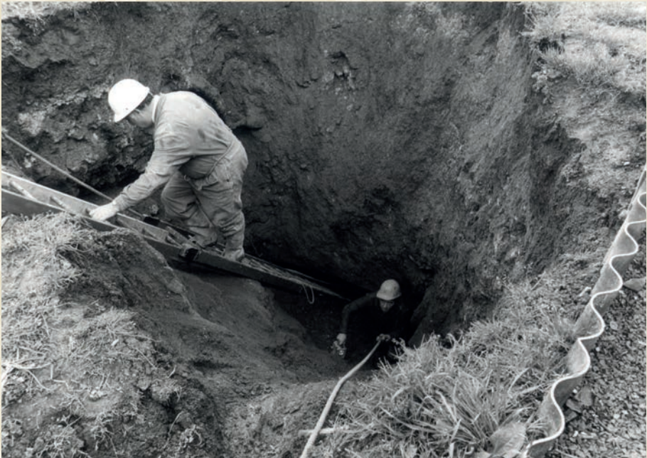
Effondrement rue de Calix en 1975.
